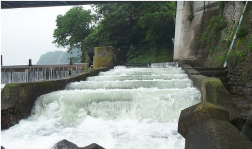
白泡が非常に多く、アユの遡上は困難である。(魚道下流より)
